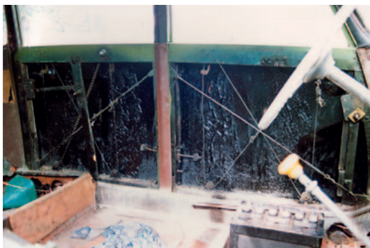
Innenleben der Türen nach Demontage der Verkleidungen
